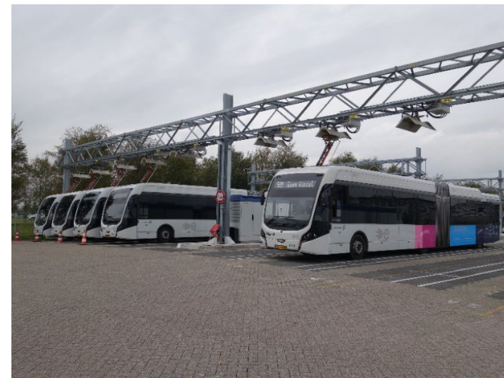
パンタグラフ式急速充電(8基)
