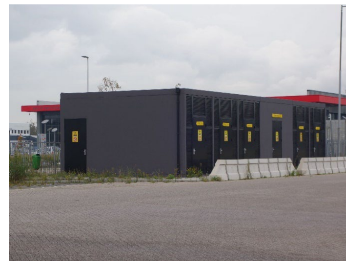
充電設備の電源装置
