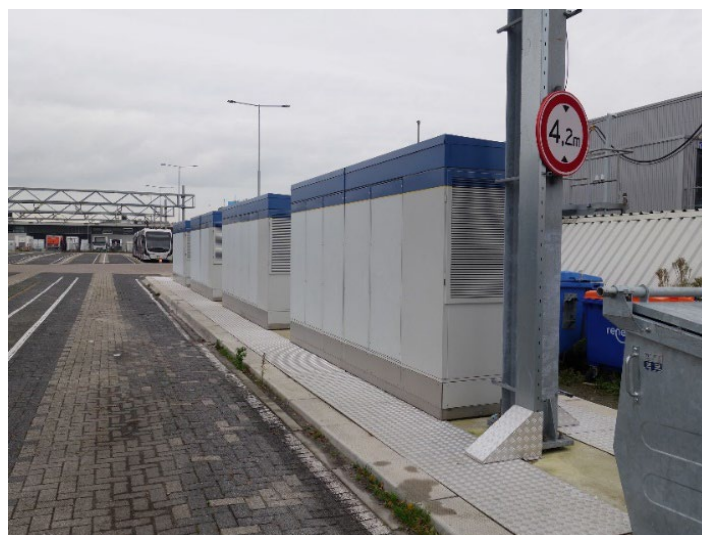
充電設備本体
